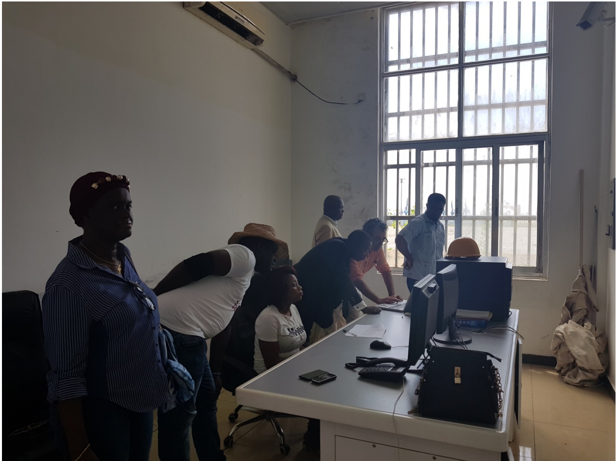
Sala de Control de la SE
