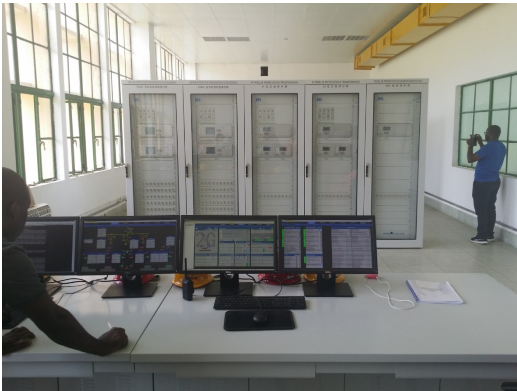
Sala de Control de la Central HE
