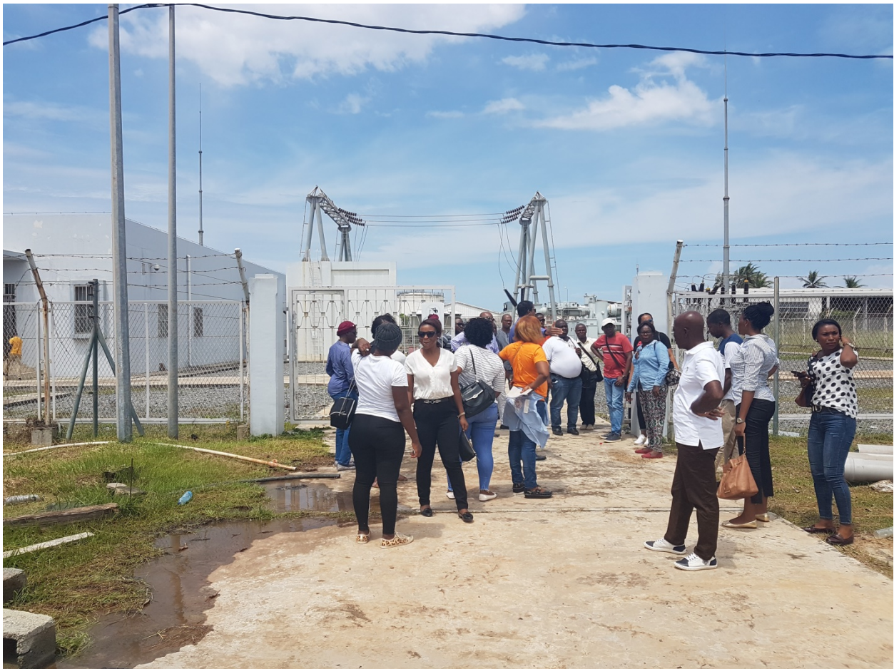
Campo de 110 kV (GIS) de la SE
